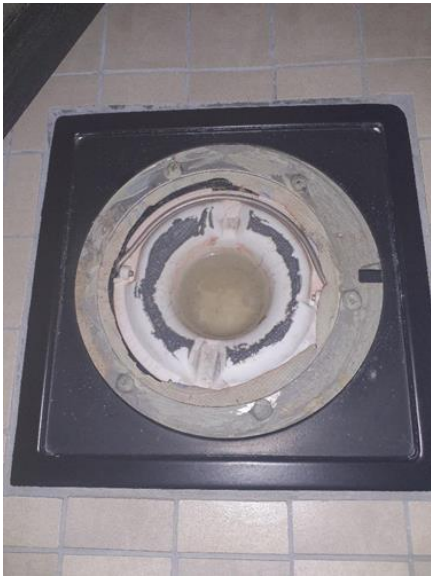
Avløpsrør (ink. sluk) - [Sluk bad.]
