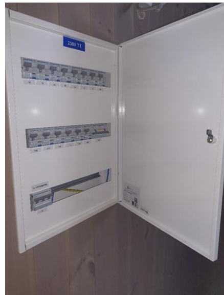
Elektrisk anlegg - [Sikringskap ]
