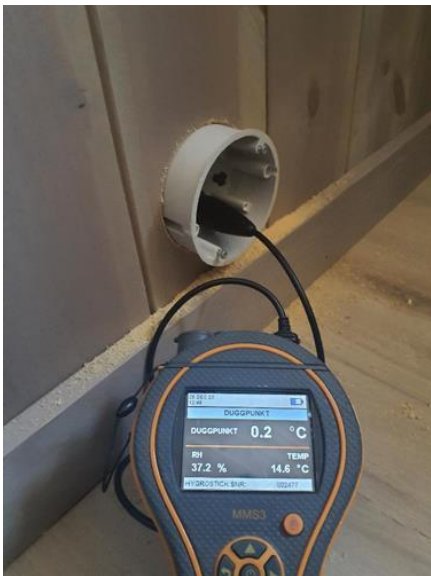
Kommentar - [Hulltaking og fuktmåling i veggkonstruksjonen mot dusjsone bad, utført fra soverom 2.]
