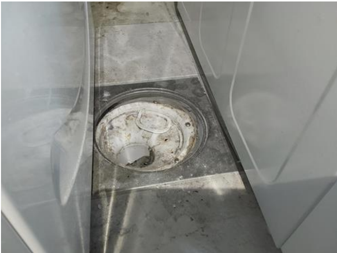
Avløpsrør (ink. sluk) - [Sluk vaskerom]
